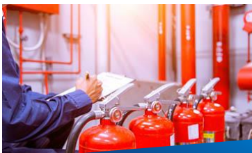
Controle Preventivo EQUIPAMENTOS P/ INCÊNDIO
